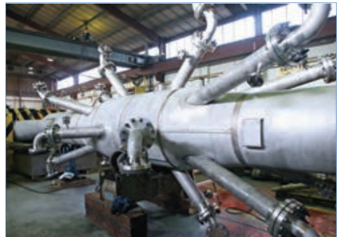
Instalación de enfriamiento en acero inoxidable 321H
